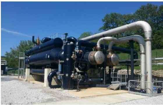
Figure 7: Gruppo Binario Bagnore (1MWe) power plant.
