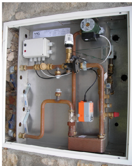
Fig. 1: Centralina di regolazione della portata di acqua calda sul lato primario, e della temperatura di utenza sul lato secondario.
