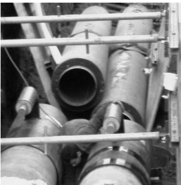
Fig. 1/b: Primo piano della coibentazione delle tubazioni di distribuzione dell'acqua
