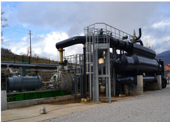
Fig. 3: Vista d'insieme del nuovo impianto di Bagnore
