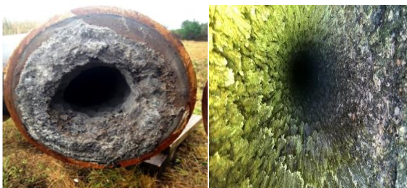
Fig. 3 - Esempi di depositi in condutture per lo sfruttamento di fluidi geotermici.
