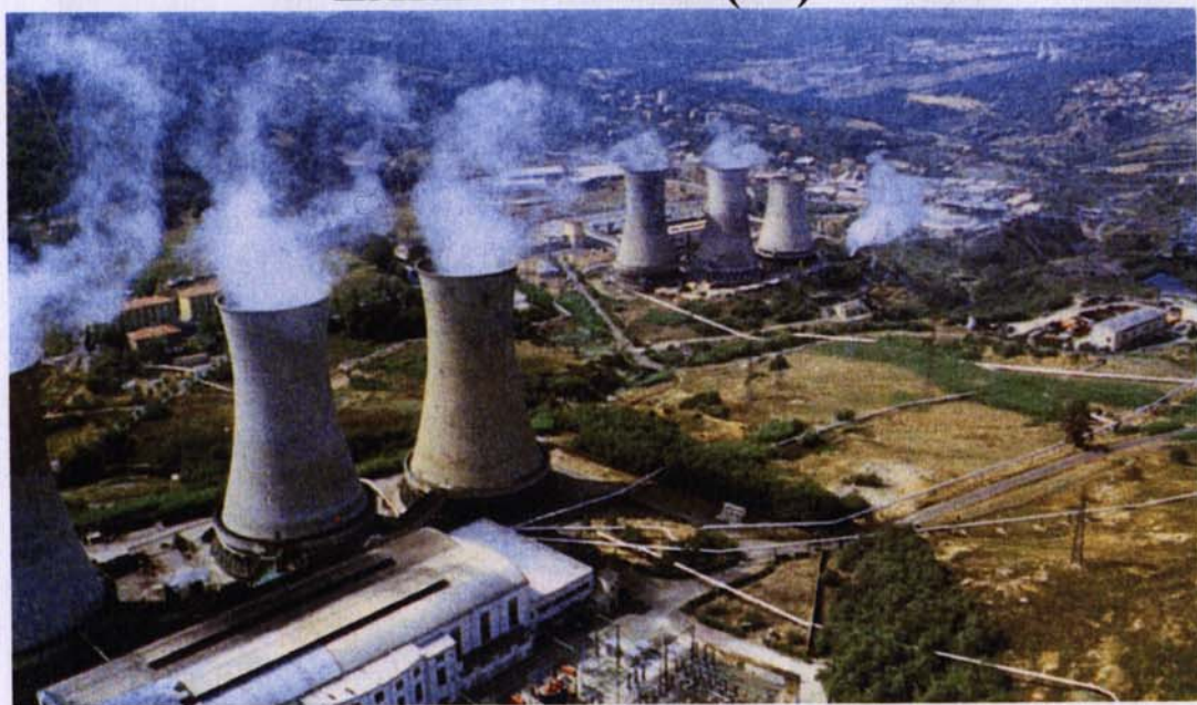
Moderne centrali Larderello 2 e Larderello 3
